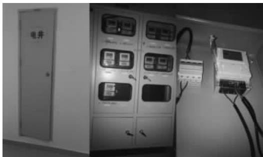
图 1 无线抄表系统安装实地
